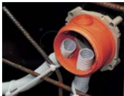
Корпус KBV и подведенные в него трубы.
